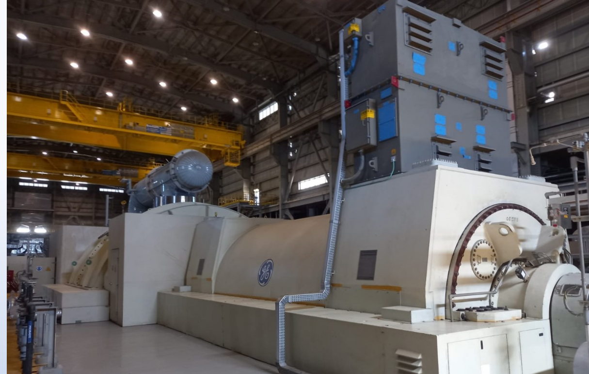
Generador Trifásico Sincrónico
