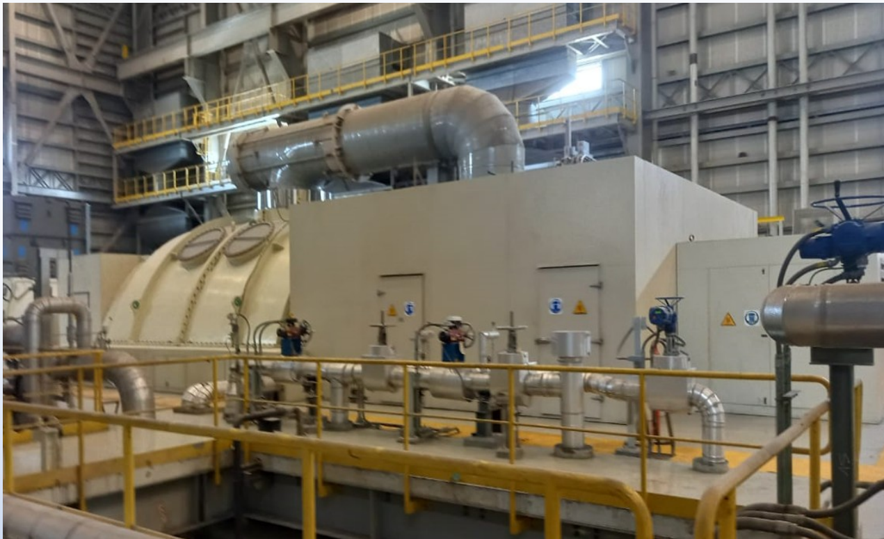
Turbina de Vapor de Tres Secciones
