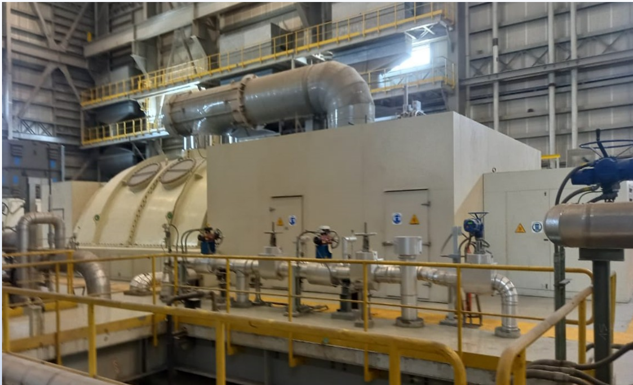
Turbina de Vapor de Tres Secciones
