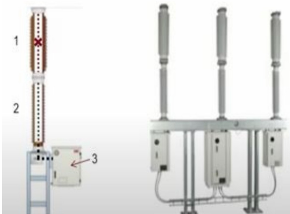
Figura 3 Interruptor SF 6 de Tanque Vivo
